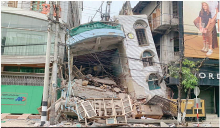
Bangunan bertingkat yang hancur dan berada di pinggir jalan di tengah Kota Mandalay. | Foto: Theophilus Yanuarto
